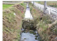
詰まった排水路
