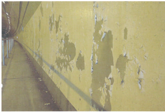
写真-3 塗装の剥離
