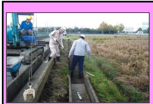
老朽化した用水路 の補修・更新など
