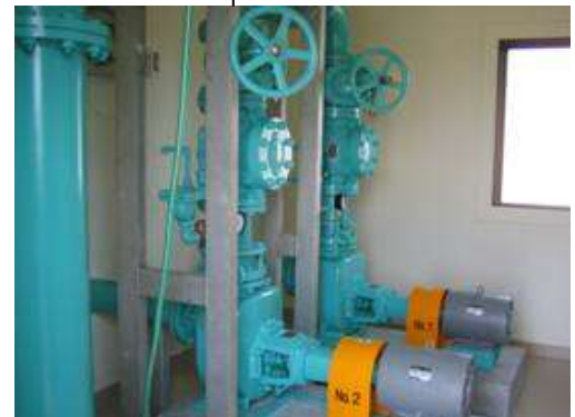
南部循環ポンプ
